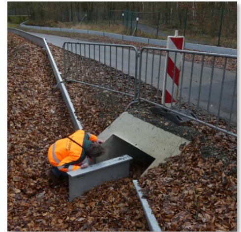
Straßenunterführung für Amphibien im Landkreis Lippe.
