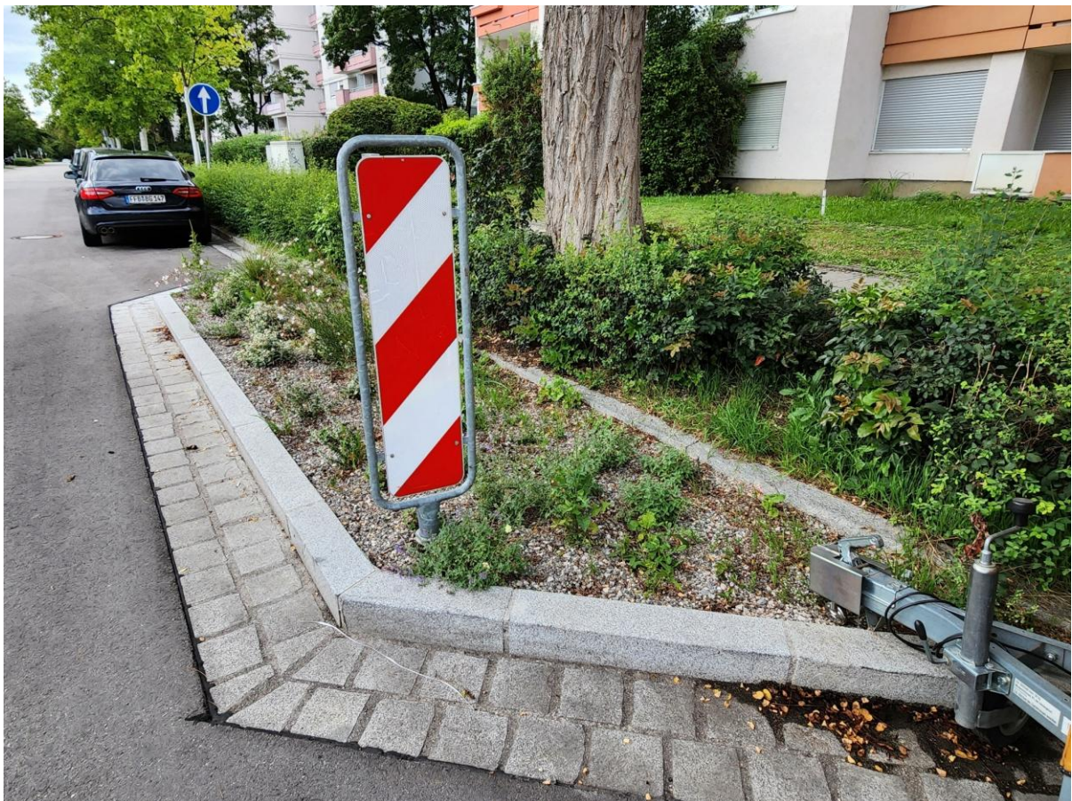
Abbildung 51 Germering: Standortvergrößerung für den Baum einer privaten Wohnsiedlung, der sonst bei Straßenarbeiten existenziell geschädigt worden wäre. Foto: Annette Hartmann 2025
