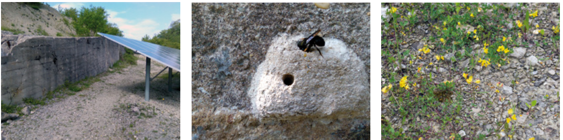
Abb.6.4: Betonwand mit den Nestern der Schwarzen Mörtelbiene, die Futterpflanze Hornklee sowie der für den Nestbau benötigte Gesteinsgrus (Fotos: Gerhard Mörsch, rechts: Bernd Demuth)
