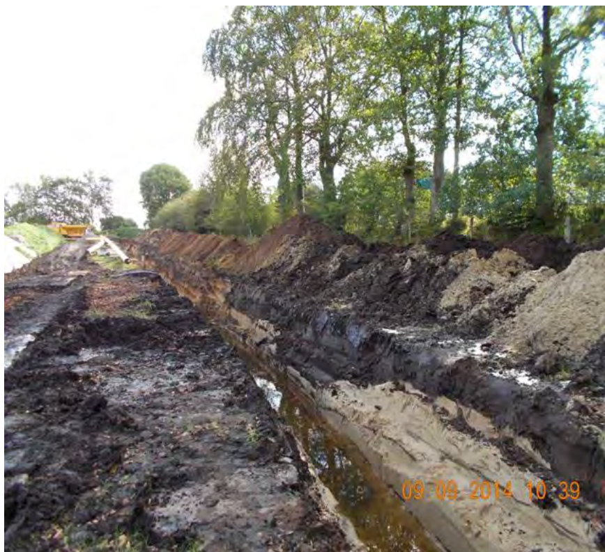
Abb.: 5.6: Leitungsbaustelle ohne Bodenschutzmaßnahmen
