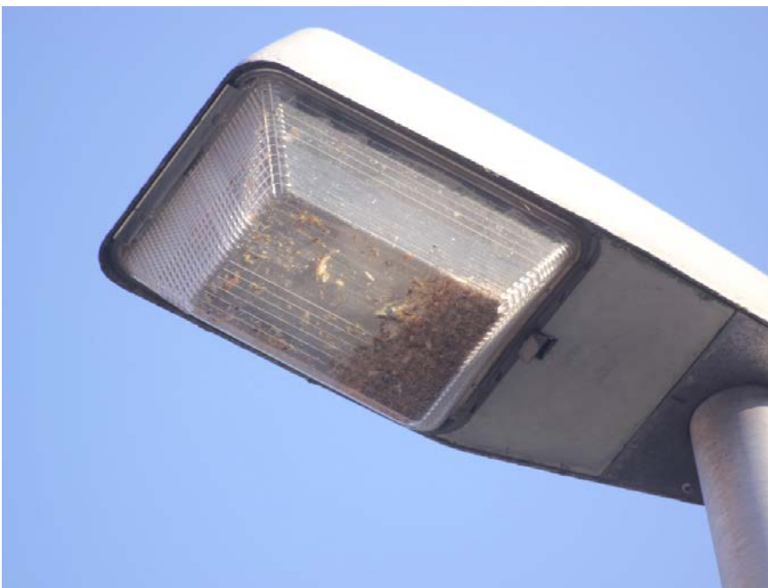
Abb. 1.4: In undichten Leuchtengehäusen sammeln sich die Insekten, die vom Licht angezogen werden.
